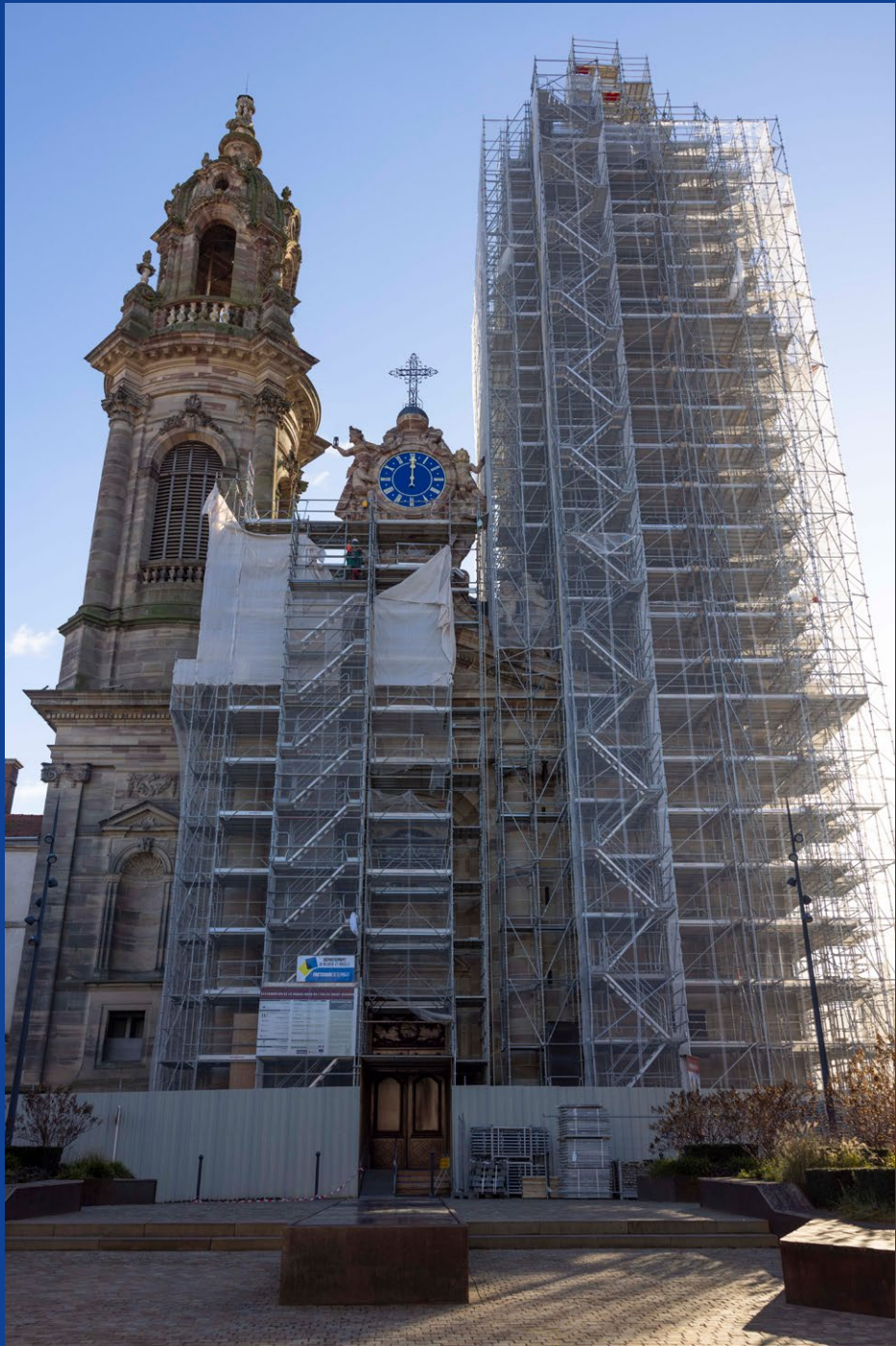
Chantier de restauration de la tour ouest de l'église Saint-Jacques, Ville de Lunéville
